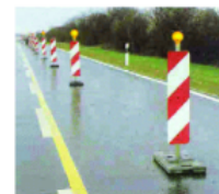
Luces amarillas fijas o intermitentes
